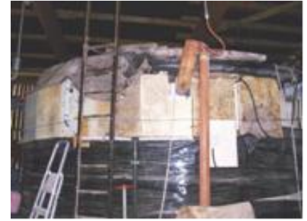
写真 11. バイオガス発生装置
