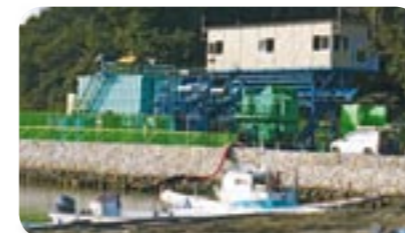
水処理プラント
