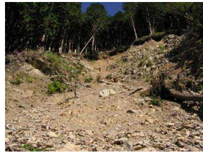
植生の回復が見られない崩壊地 (西の川流域) (治山による植生復元を実施)
