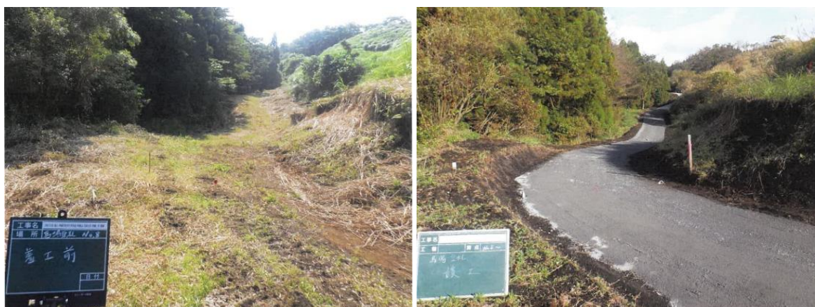
写真3-1 令和3年度に整備した馬場豆札牧野における管理道兼防火帯 (左：工事前、右：工事後)
