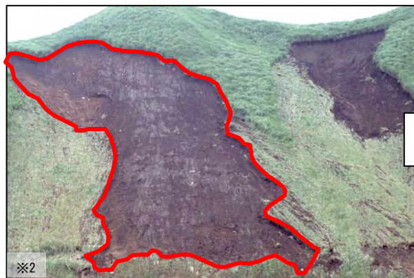
1990 年豪雨による表層の崩落
