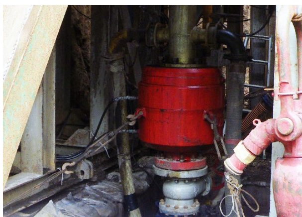
アニュラータイプ BOP 設置状況
