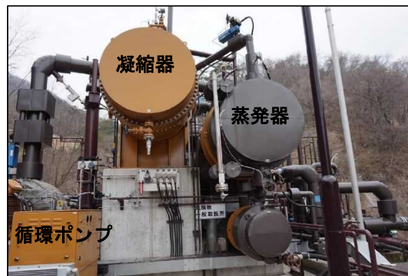
写真6 蒸発器・凝縮器
