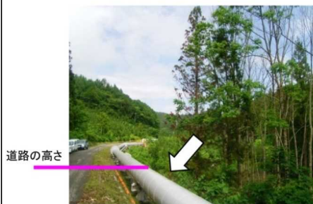
○上の岱地熱発電所
