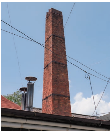
山村酒造のシンボルだった煉瓦造りの煙突。以前は高さ約15メートルあったが、熊本地震をきっかけに低くした。
