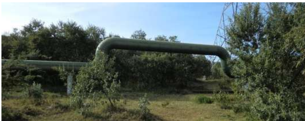
写真：蒸気パイプのループ構造（低背動物の通行用）、緑色にペイントされている。
