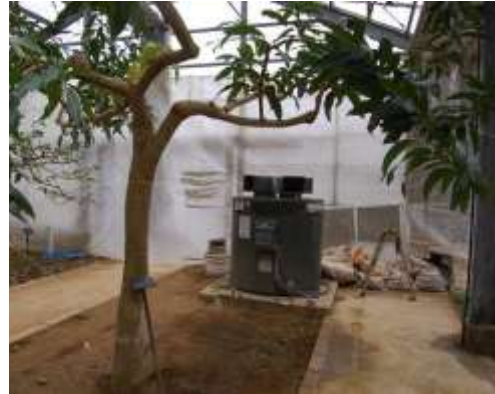
地熱の温水を活用した温室内の送風機
