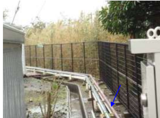
還元井への配管
