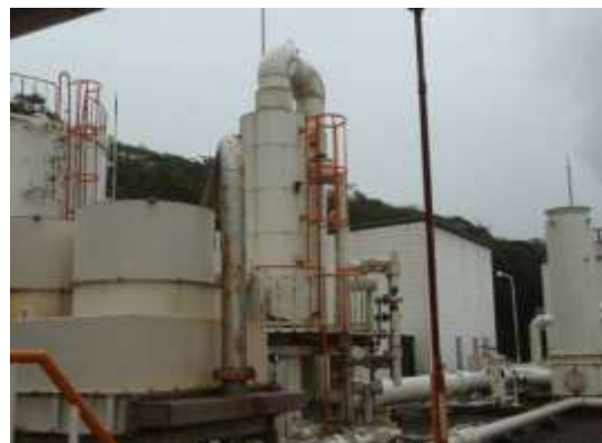
気水分離器（高さ 5.4m）
