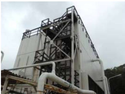
冷却塔（高さ 13.0m）
