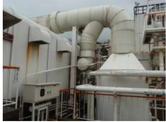
復水器（高さ 3.6m）
