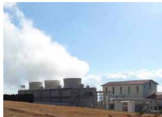
冷却塔から立ち上る水蒸気
