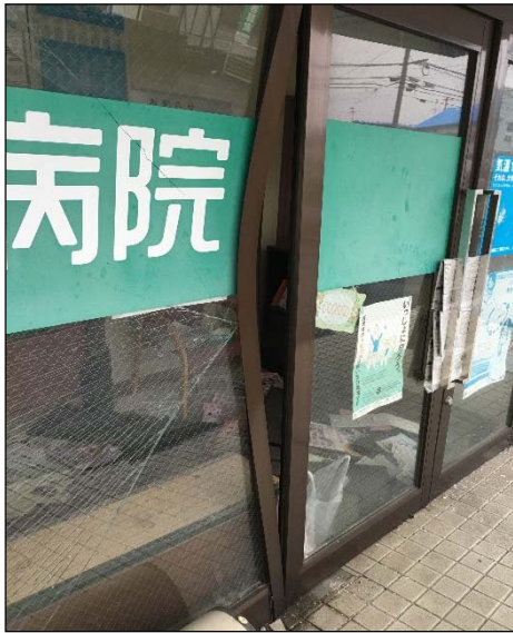
全壊した動物病院（熊本市東区）
