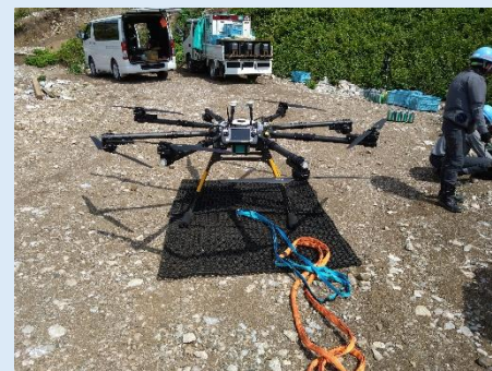
使用したドローン
