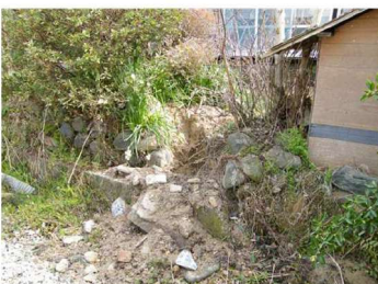
住居石垣の掘起し被害
