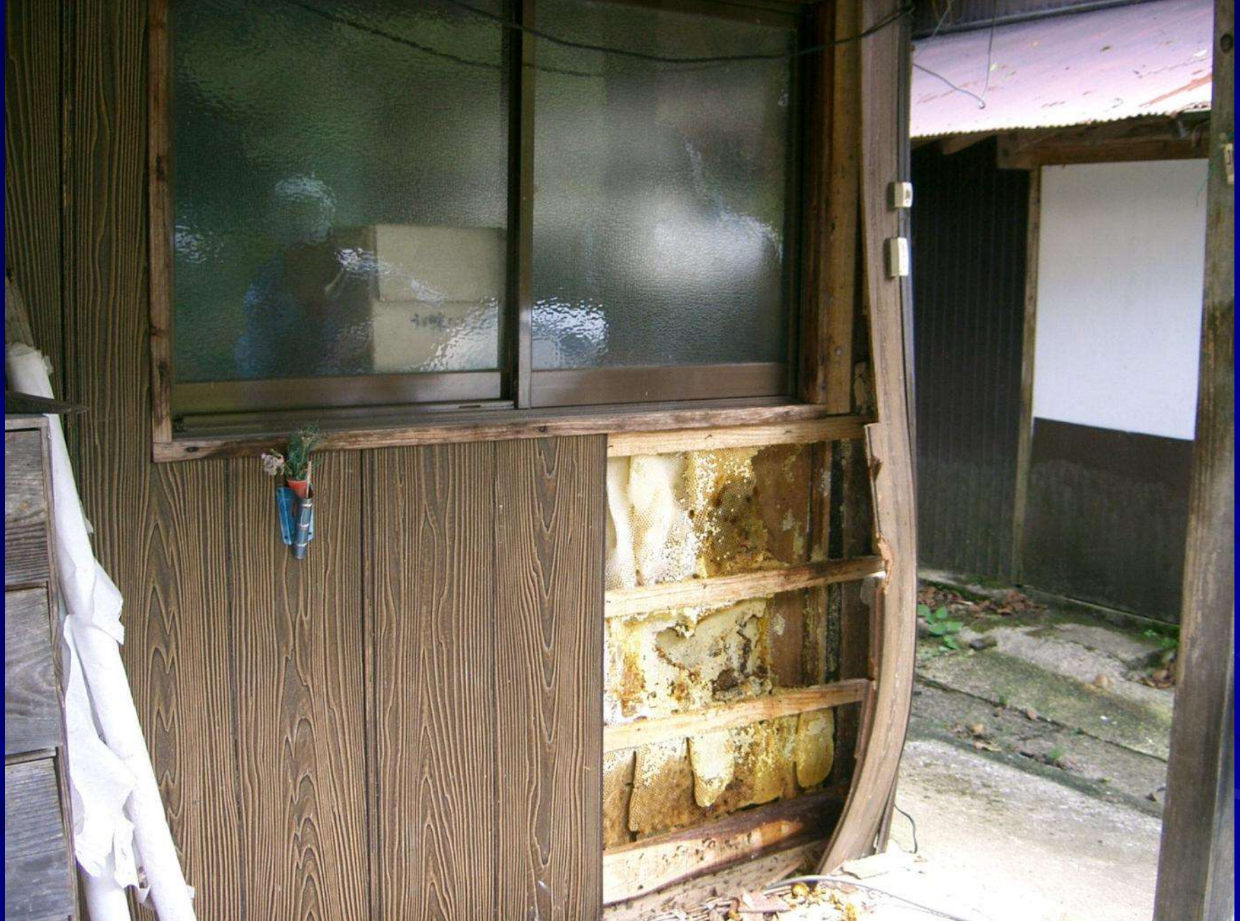
民家の壁に営巣した蜂巣の被害
