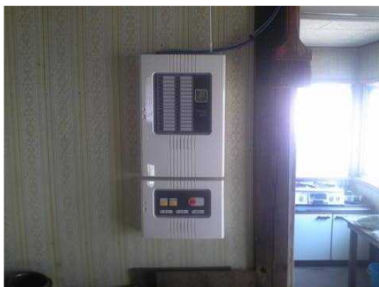
多チャンネル受信ユニットと自動通報装置
