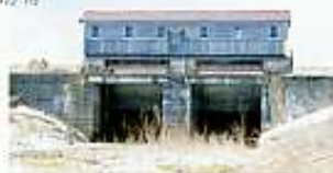
▲新潟県川口(旧安水)水門
