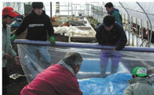
水質浄化実証試験に使用する水槽に水が漏れないようにビニールを張っているところ
