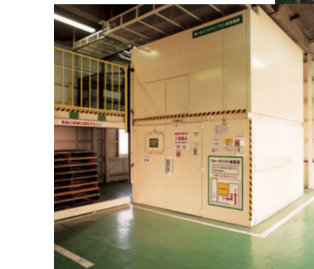
センターの一角には廃プラスチックを砕く破砕機が設置。
