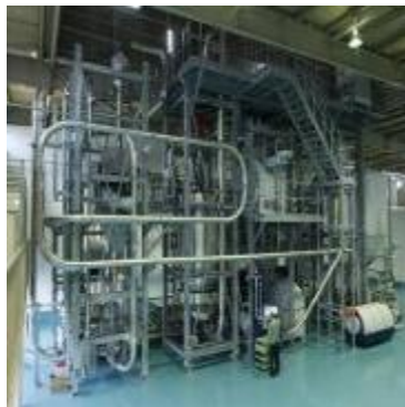
揮発留分除去プラント
