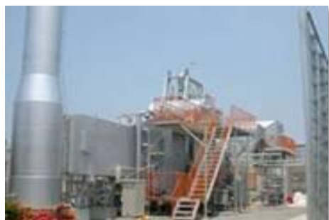
コ・ジェネレーションシステム
