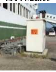
電力供給設備
