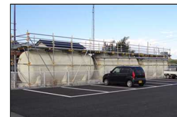
【応急仮設住宅に設置された浄化槽】
