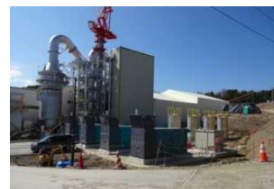
葛尾村の仮設焼却施設 (平成27年4月)
