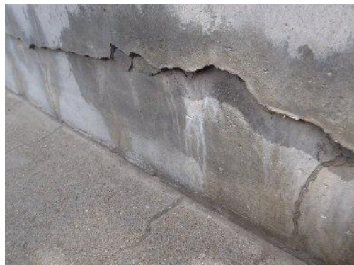
外壁の亀裂 (裏磐梯自然保護官事務所)
