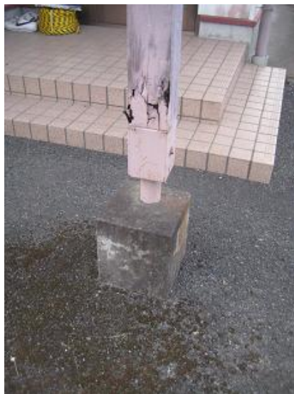
柱の老朽化(小林庁舎)
