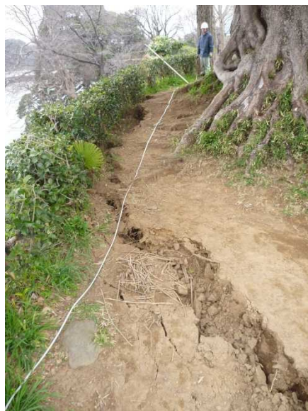
代官町通遊歩道亀裂
