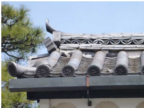
桜田門瓦崩落
