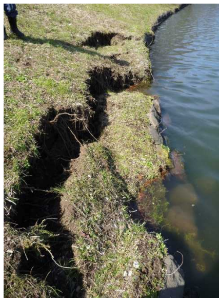
桜田濠石垣崩落
