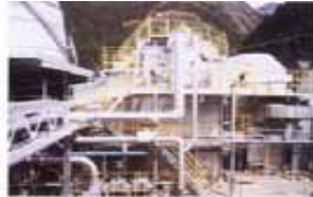
木くずだきボイラー
