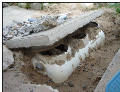
能登半島地震 浄化槽被害 (2007. 3)
