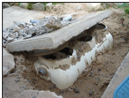
能登半島地震 浄化槽被害(2007.3)
