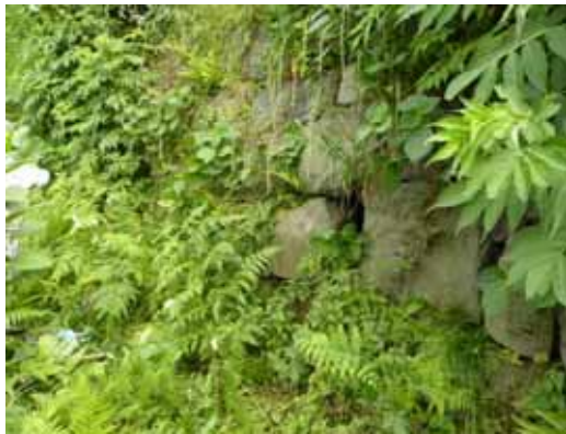
草本が繁茂する石垣
