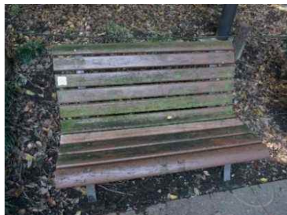
コケの付着、劣化がみられる木製ベンチ
