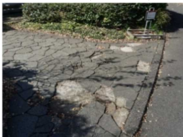
舗装材の剥がれ
