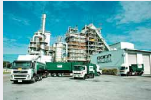
Source : DOWA Eco-System Co., Ltd.
