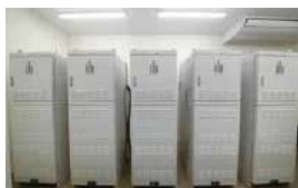
リチウムイオン蓄電池
