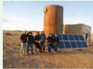
太陽光パネルによる揚水システム
