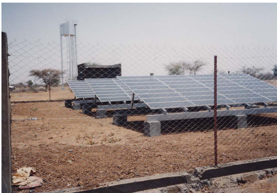
写真 7.1 揚水のための太陽光発電施設
