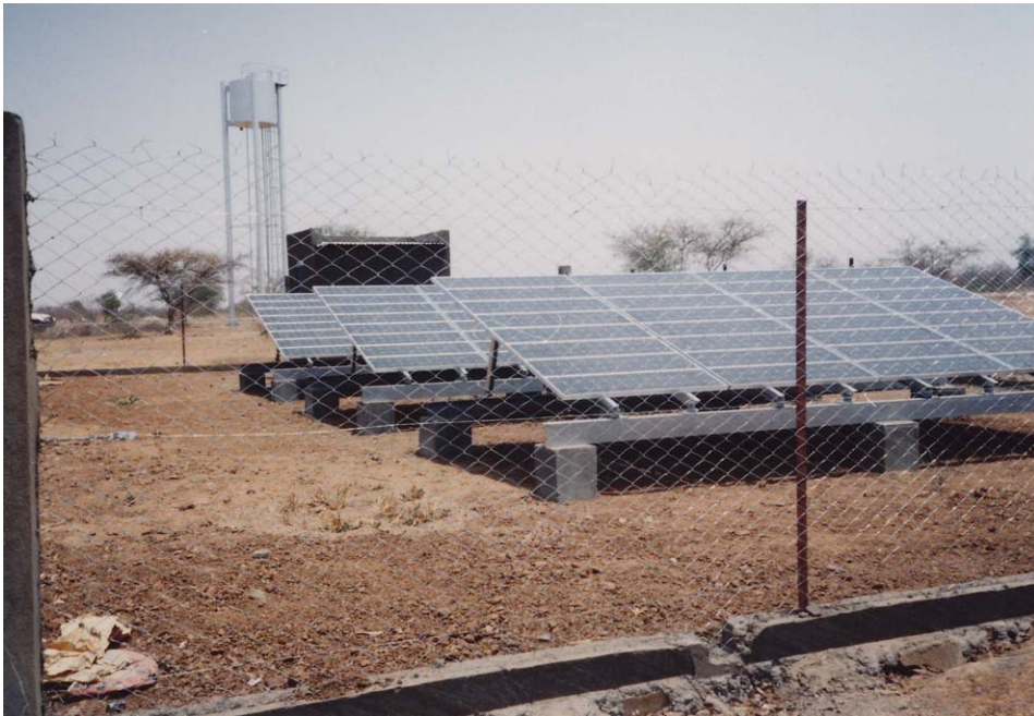
写真 7.1 揚水のための太陽光発電施設
