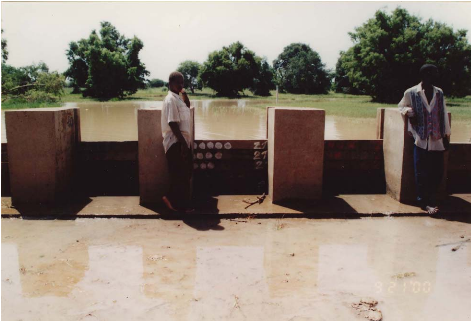
写真 7.5 本事業で設置された「水門式小規模ダム」
