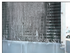
室外機の腐食
