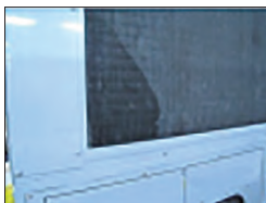
室外機の油にじみ
