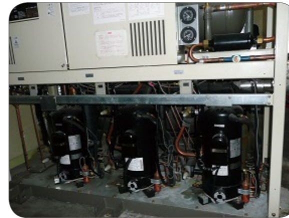
ユニット型冷凍機の異常振動確認
