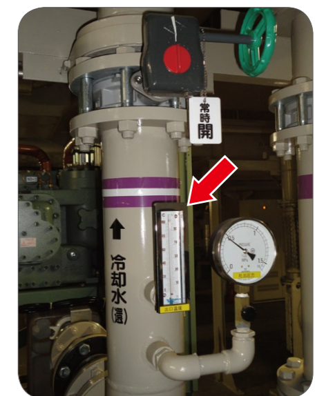
冷却水出口温度計確認
