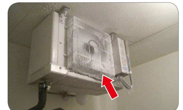
冷却器の内部霜付き異常
