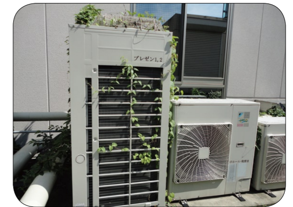
草で覆われた室外機
