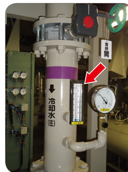
冷却水入口温度計確認
