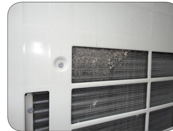
室外機に付着したゴミ
