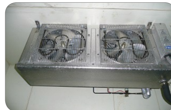
冷蔵庫内正常な冷却器外観
