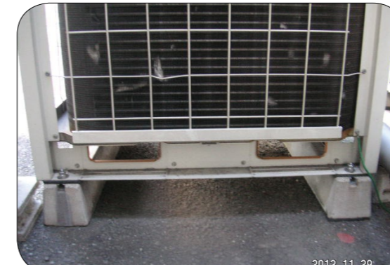
室外機のキズ
