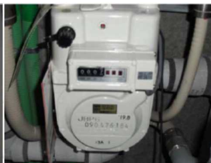
ガスメーター
