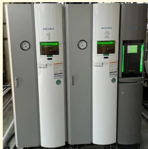
LPガスボイラー
