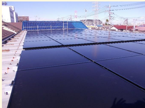
屋根に設置した太陽光発電設備（三郷 CKTC）
