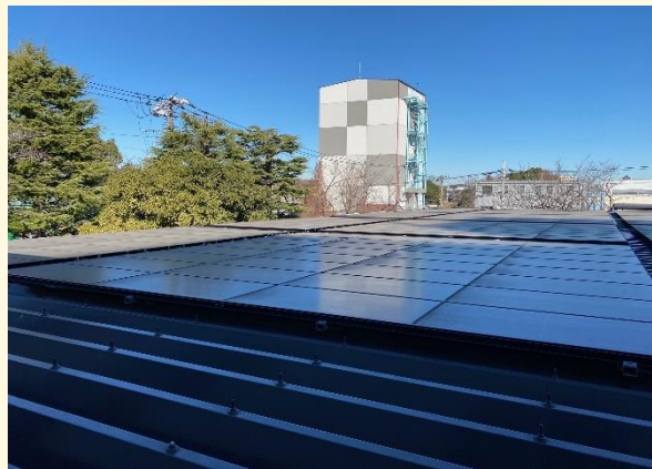
印刷工場の屋根に設置した太陽光発電
