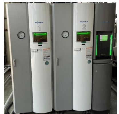
LPガスボイラー
