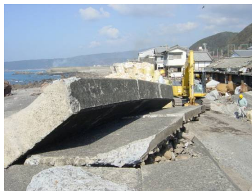
図 5-3 高知県菜生海岸 なばえ の被災 （写真提供：福濱方哉 国土交通省北陸地方整備局黒部河川事務所長）
