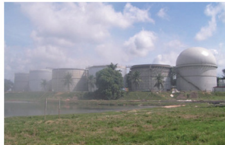
FELDA社工場で稼働中の排水処理タンク
