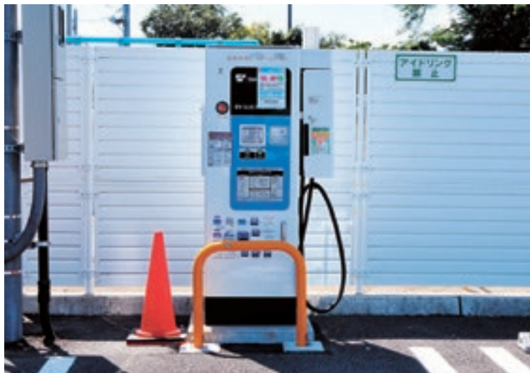
環境にやさしい電気自動車の急速充電器28基を整備
