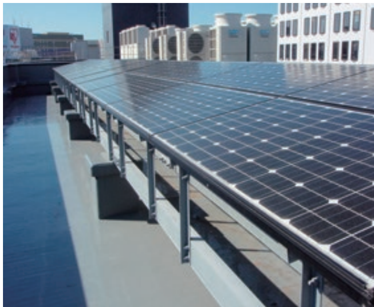
FKビル再生エネルギー太陽光発電設備5.02kw
