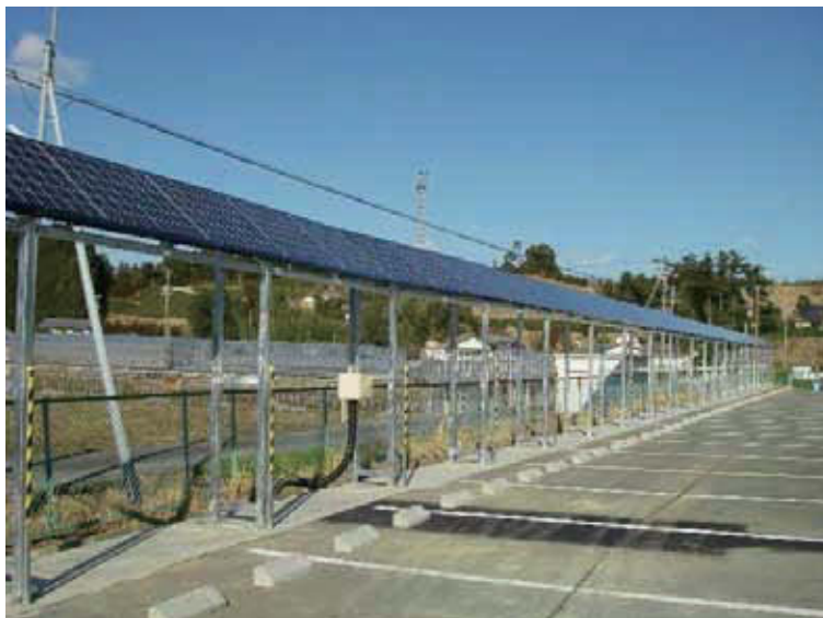
古紙回収の収益で小学校に設置した太陽光発電設備
