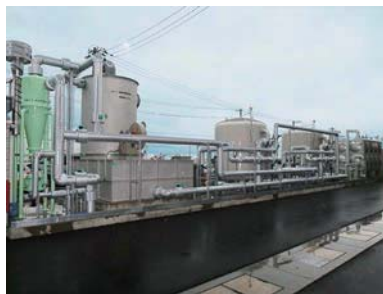
井水処理設備
