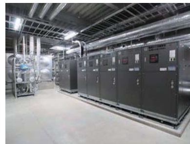
水冷ヒートポンプチラー
