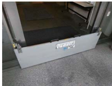
事務所等の水害対策の一例（止水板）
