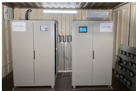
純水素発電システム(10kW)の全体
