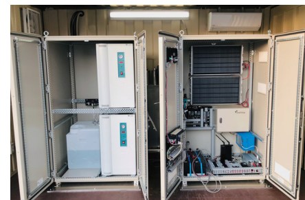
純水素発電システム(10kW)の扉開放
