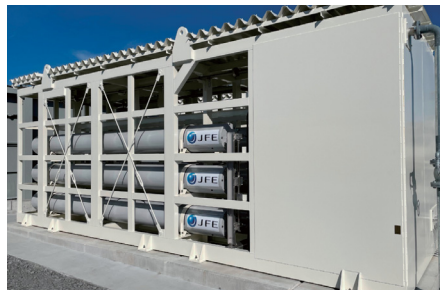
蓄圧器の設置施設 実例の外観(福島県浪江町)
